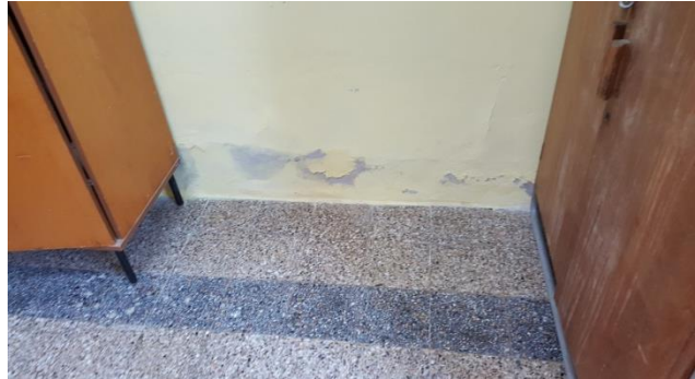
● Foto particolare umidità nella parete;
