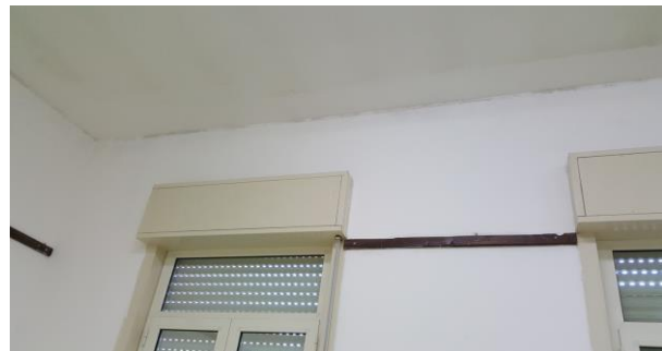
● Foto particolare infiltrazioni solaio del piano terra
