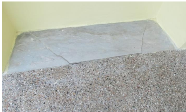
● Foto lastra danneggiata pavimento;
