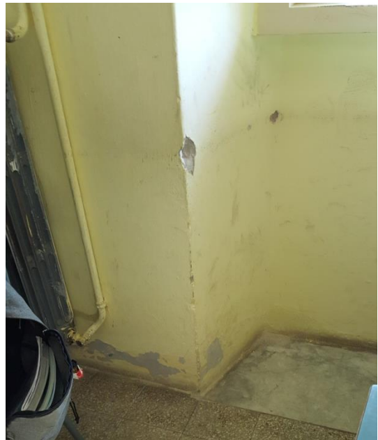
● Foto particolare umidità nella parete;
