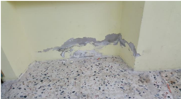
● Foto particolare umidità nella parete;
