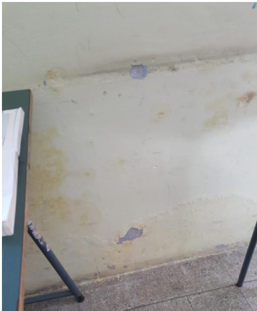
● Foto corrosione da sfregamento sulla parete;
