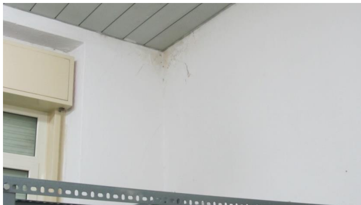
● Foto particolare fessure inclinate
