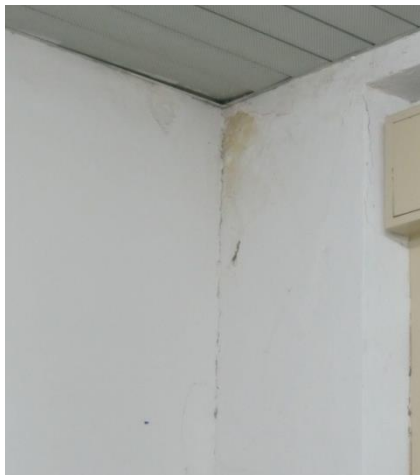
● Foto particolare fessure verticali
