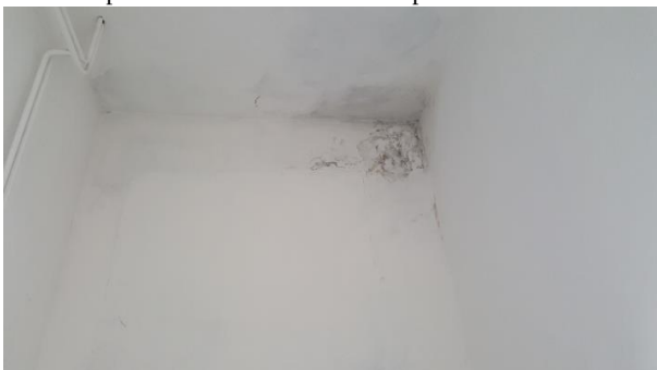
● Foto particolare infiltrazione nel solaio dei bagni al p.t.
