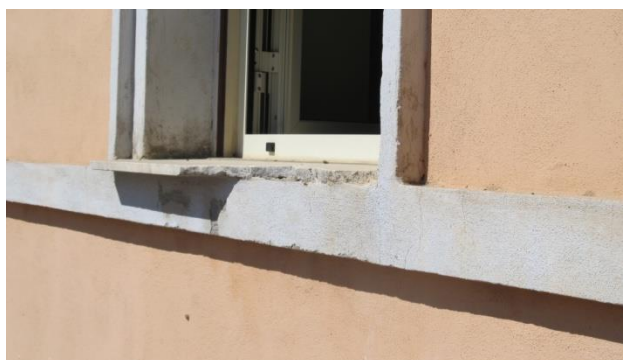
● Foto davanzale danneggiato;
