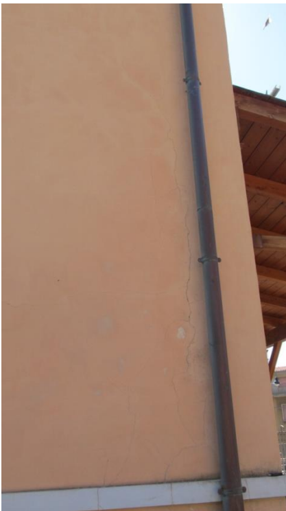
● Foto lesione verticale muratura portante
